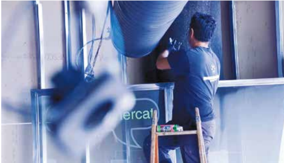
El propietari del bar El Racó del Mercat, Joaquín Torres, treballant dimarts en les instal·lacions del seu establiment. || C. DÍAZ
