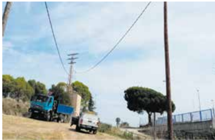
Estat de les obres de soterrament de la línia de mitjana tensió. || CEDIDA
