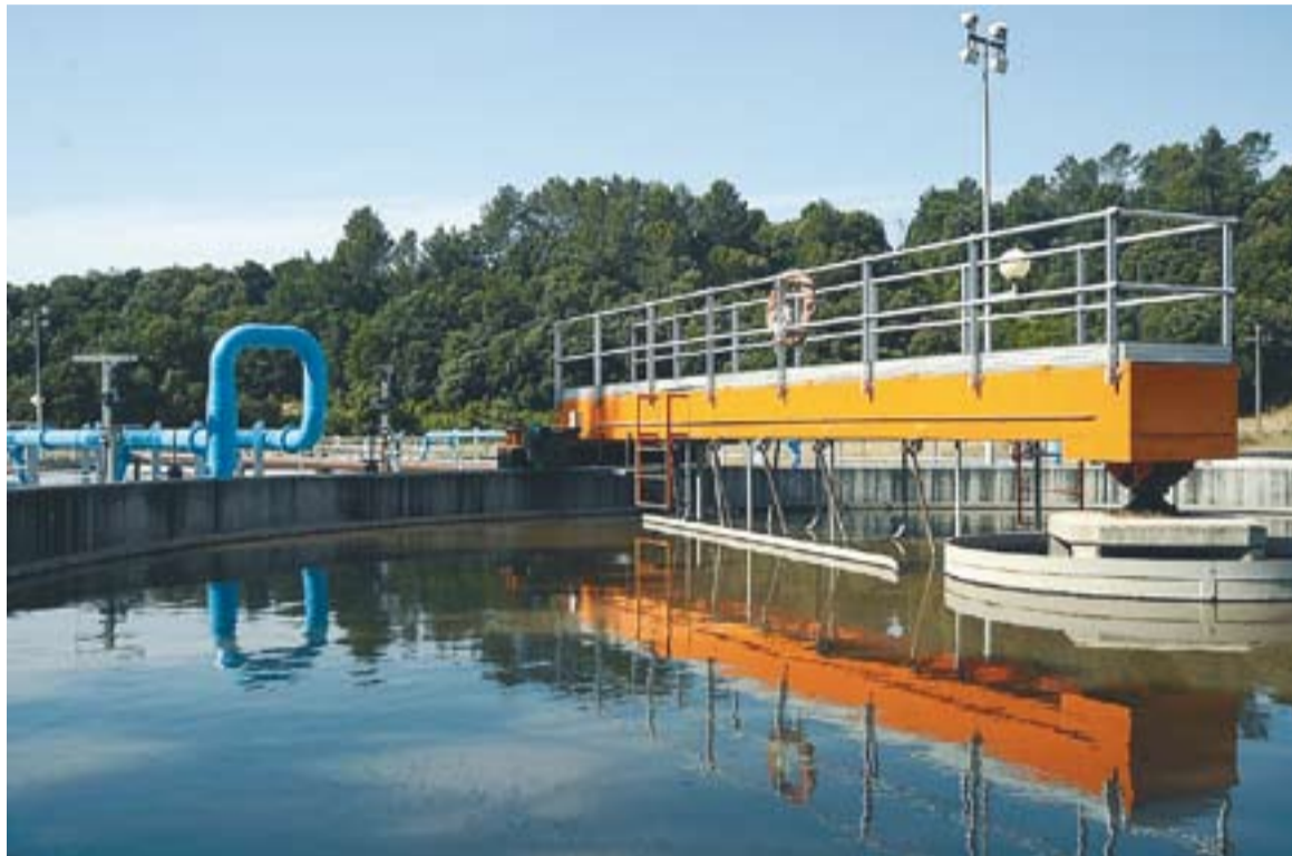
⊕ L'estació depuradora d'aigües residuals del riu Ripoll recull les aigües residuals del municipi i de les indústries || J.G.
