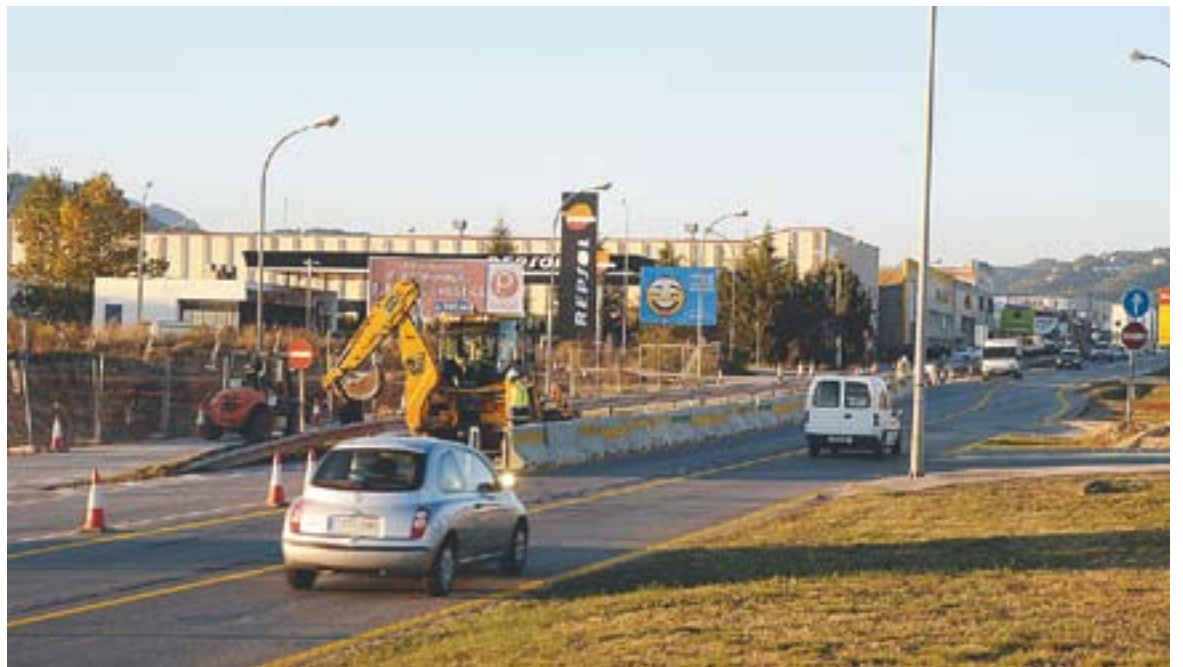
© Dimarts ja es va modificar el trajecte de la carretera per poder començar les obres de la rotonda || J.G.
