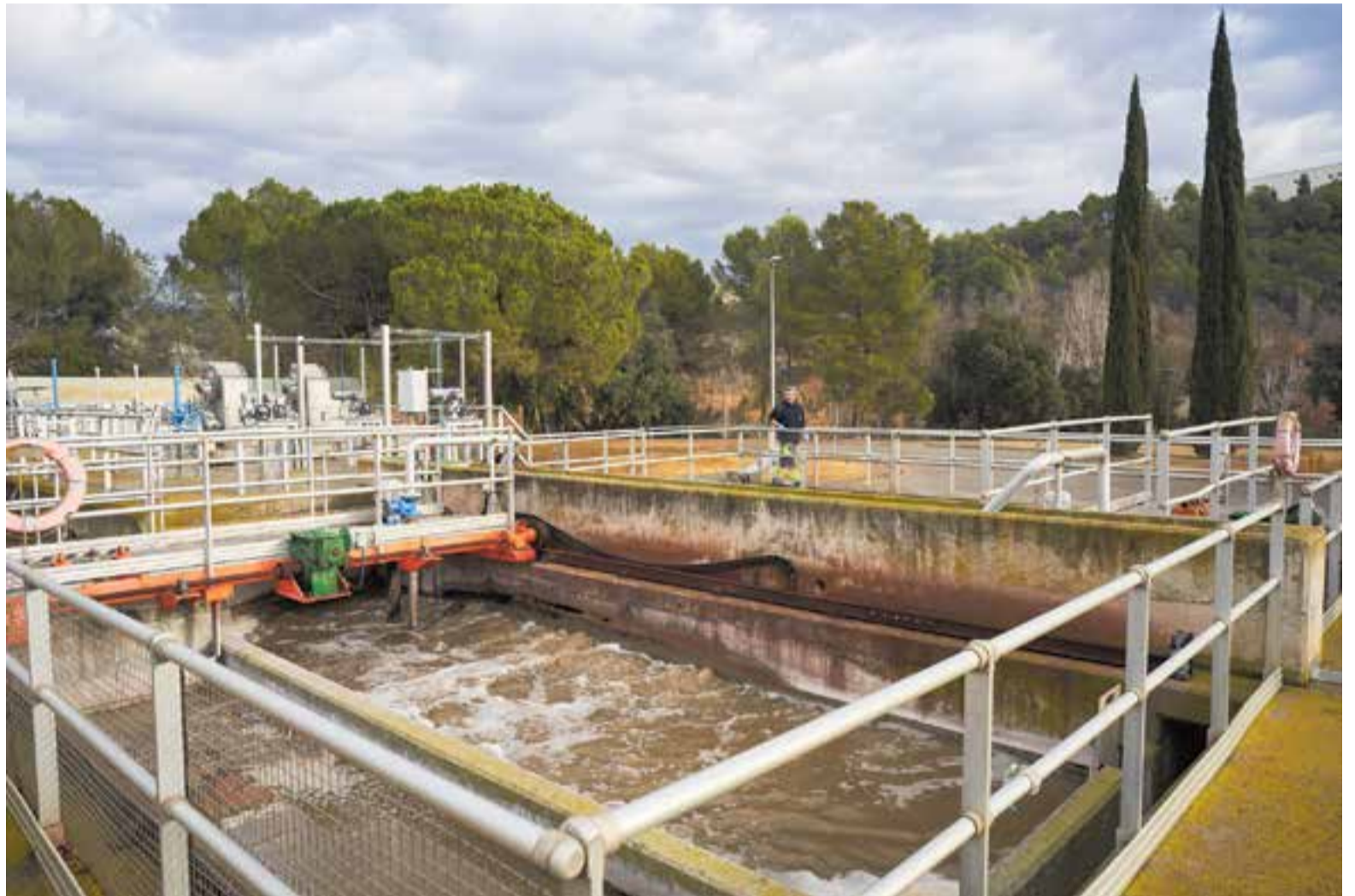
Instal·lacions de l'estació depuradora d'aigües de Castellà del Vallès en una imatge de fa unes setmanes. || Q. PASCUAL
