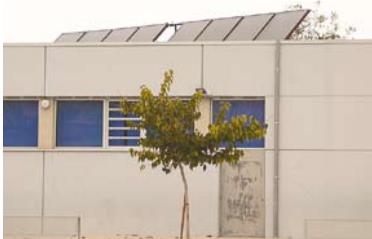
© Plaques fotovoltaïques instal·lades a uns dels col·legis de la vila. || ARXIU
